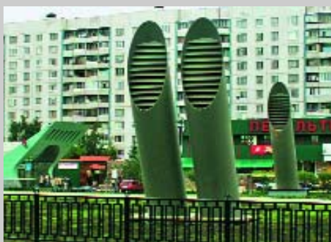
Вентилюет станции метро «Строгино». Активная форма, вписанная в ландшафт и многократно повторенная, оказалась способной композиционно удерживать весь Строгинский бульвар.
