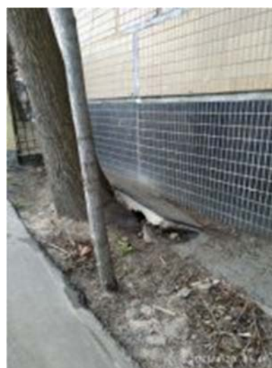
Рис. 7. Рост дерева опрокидывает бетонную плиту
